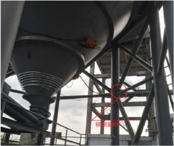
飞灰罐区视频监控
